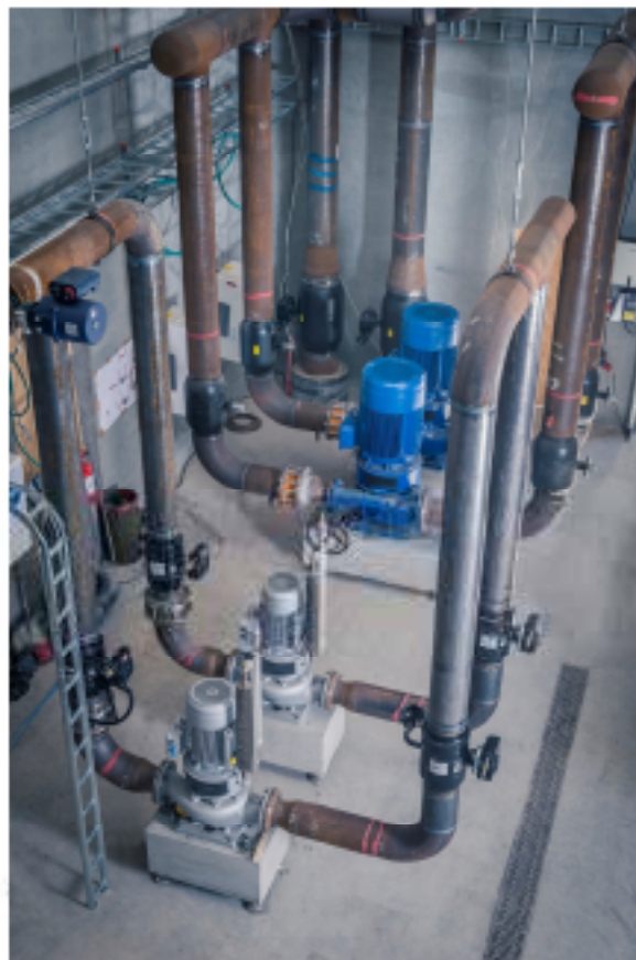
Hobro Fjernvarme: Pumpestation med BROEN Ballomax® ventiler
